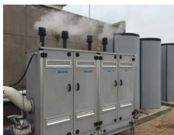
Nuevo equipo de climatización, Sevilla
