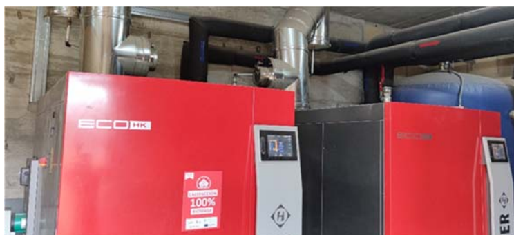
Etiqueta REPLACE en caldera de biomasa
